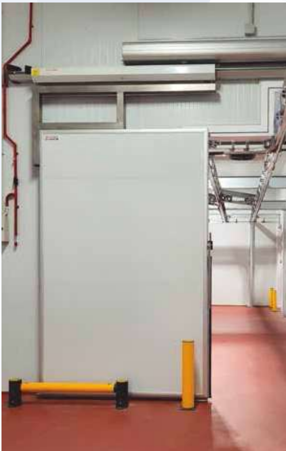
Corredera frigorífica con capilla francesa.
