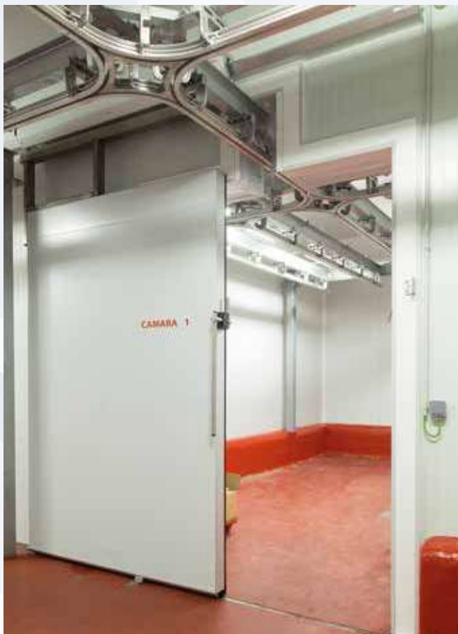
Corredera frigorífica paso aéreo.
